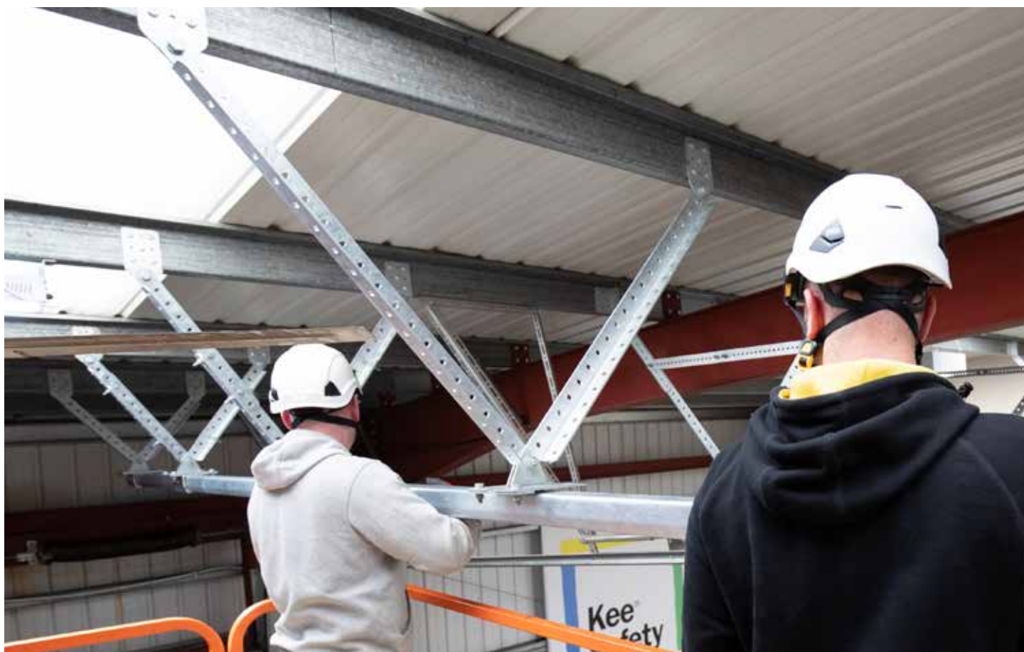
Zwei Monteure, die eine erhöhte Plattform verwenden, befestigen die Schiene an der Dachinfrastruktur.
